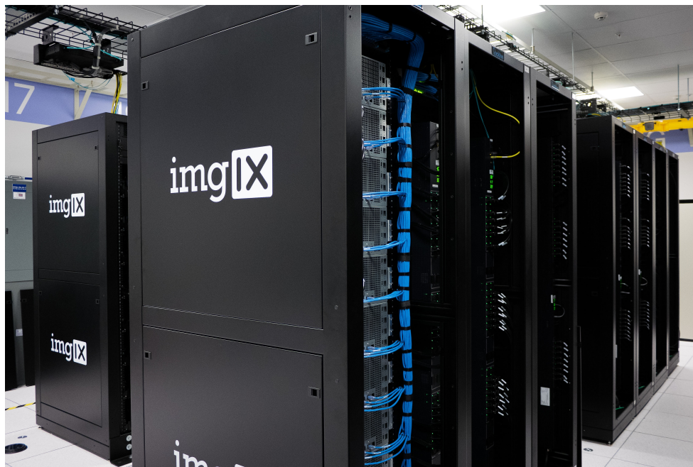
Figur 5.8: Nogle server racks, formentlig i et datacenter
